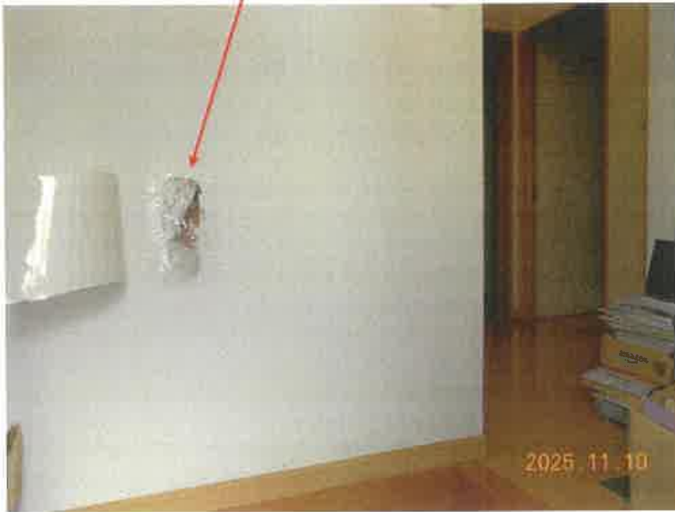
写真5 本件建物1階玄関付近の内壁の損傷（穴）箇所
