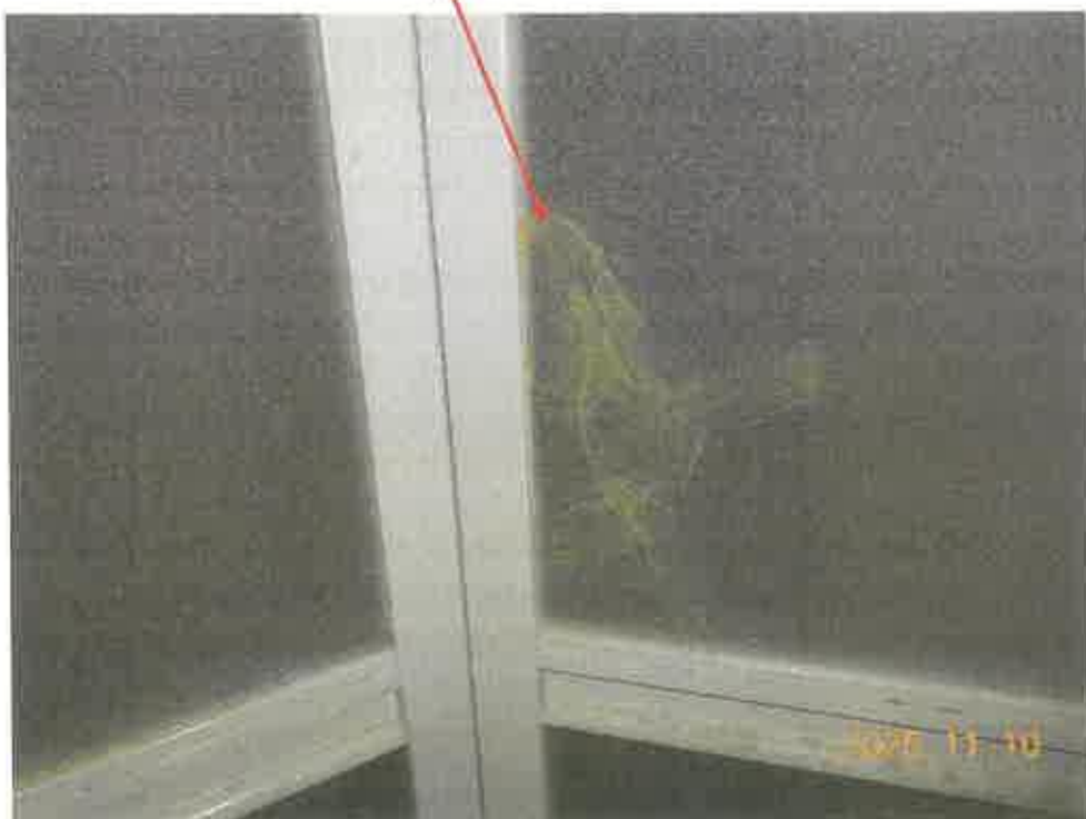
写真 1 2 本件建物 1 階浴室扉のひび割れ箇所（撮影位置の図示は省略）
