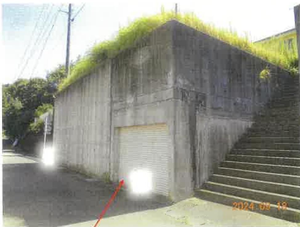
目的外建物（未登記・掘込車庫）
