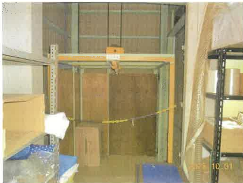
写真18 1階倉庫の荷物用エレベーター
