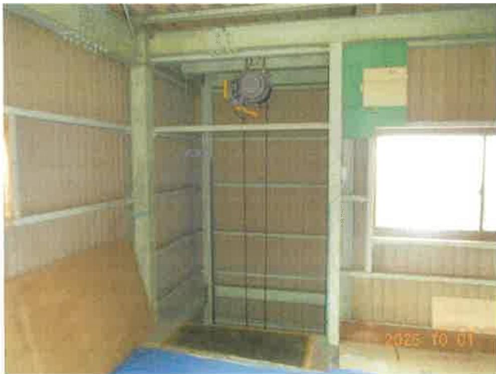
写真 2 1 2階倉庫部分の荷物用エレベーター
