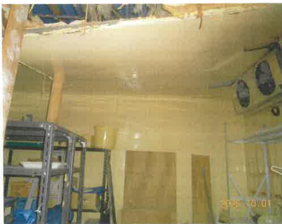
写真10 上記写真9の冷蔵庫内の天井部分の一部破損箇所
