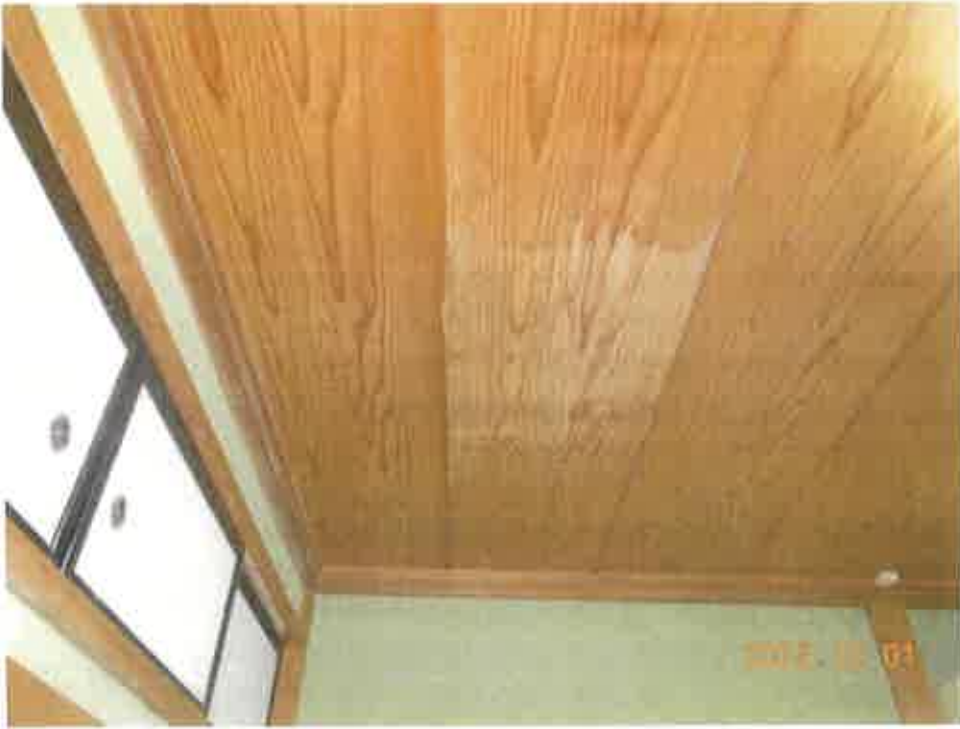
写真15 物件3の建物南東側和室の天井部分の雨漏り跡（撮影位置の図示は省略）
