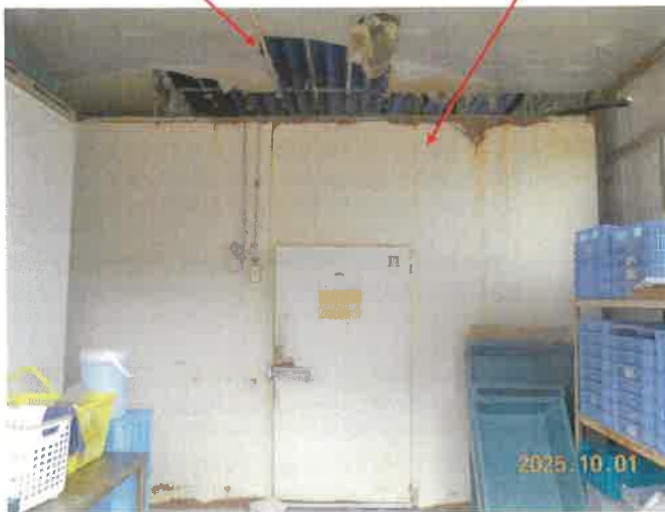
写真9 物件4の建物の天井部分の一部破損箇所 冷蔵庫
