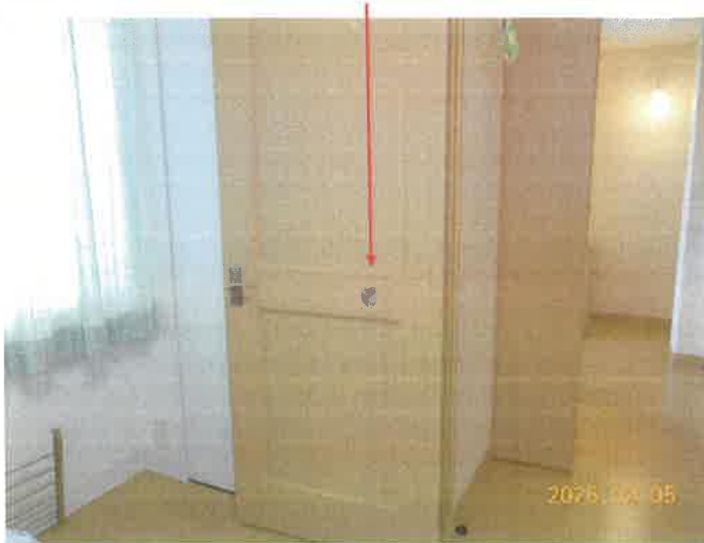
写真18 上記写真16の洋室の室内ドアの損傷（穴）箇所（撮影位置の図示は省略）
