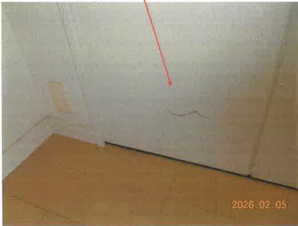
写真19 上記写真16の洋室の扉の損傷箇所（撮影位置の図示は省略）
