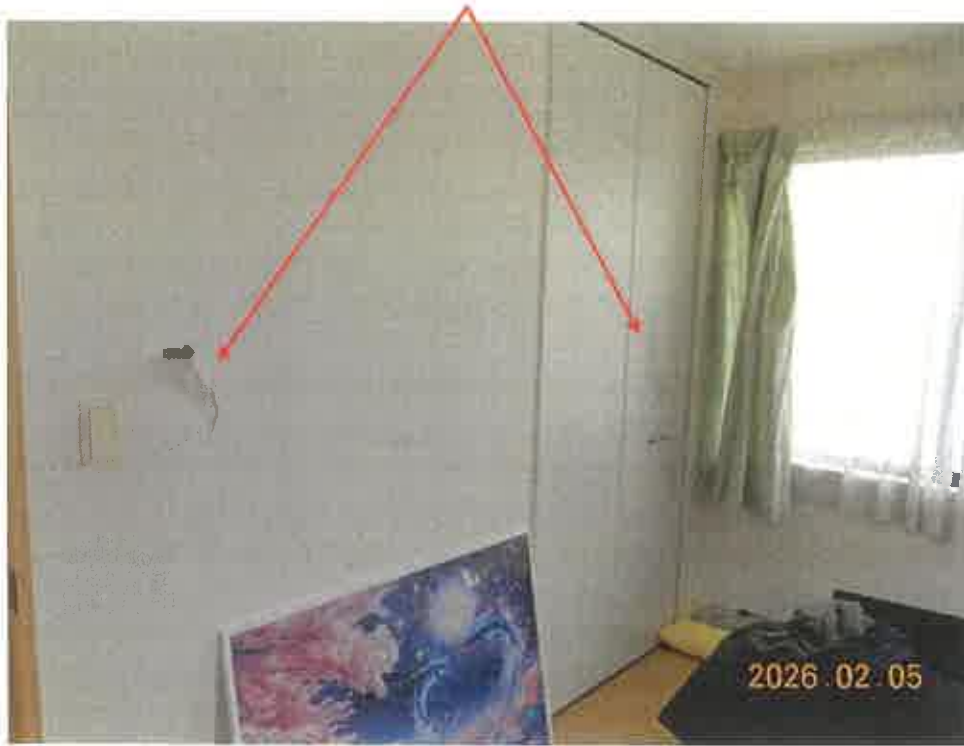
写真15 上記写真14の洋室内の壁穴及び扉の損傷箇所（撮影位置の図示は省略）
