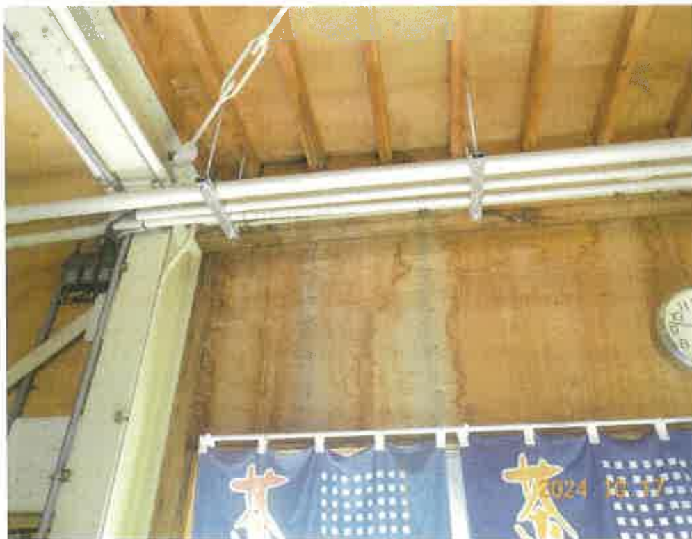
写真 2 4 物件 6 の建物内の天井、内壁の雨漏り箇所
