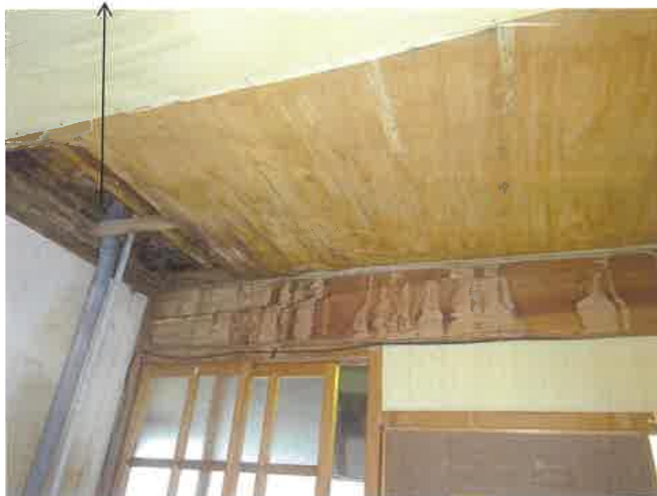
(20) 物件3 雨漏り部分
