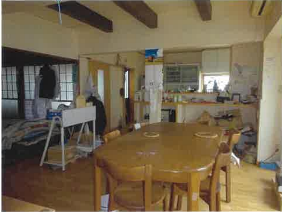
(5) 物件2 2階への折畳式階段設置部分
