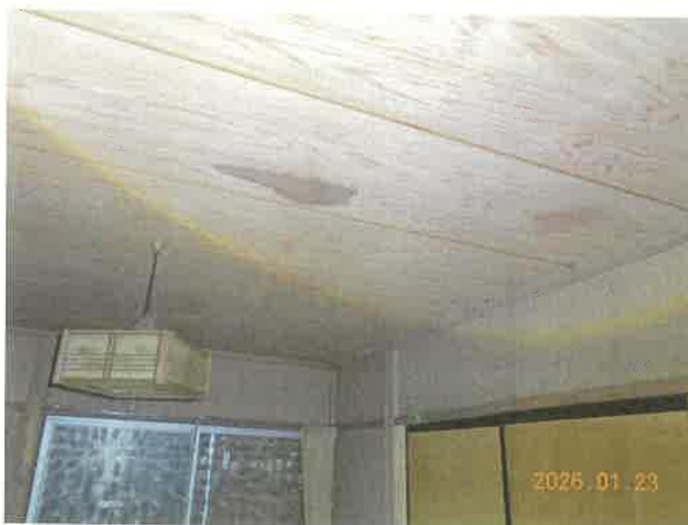
写真 1 6 上記写真 1 5 の天井部分の雨漏り跡（撮影位置の図示は省略）
