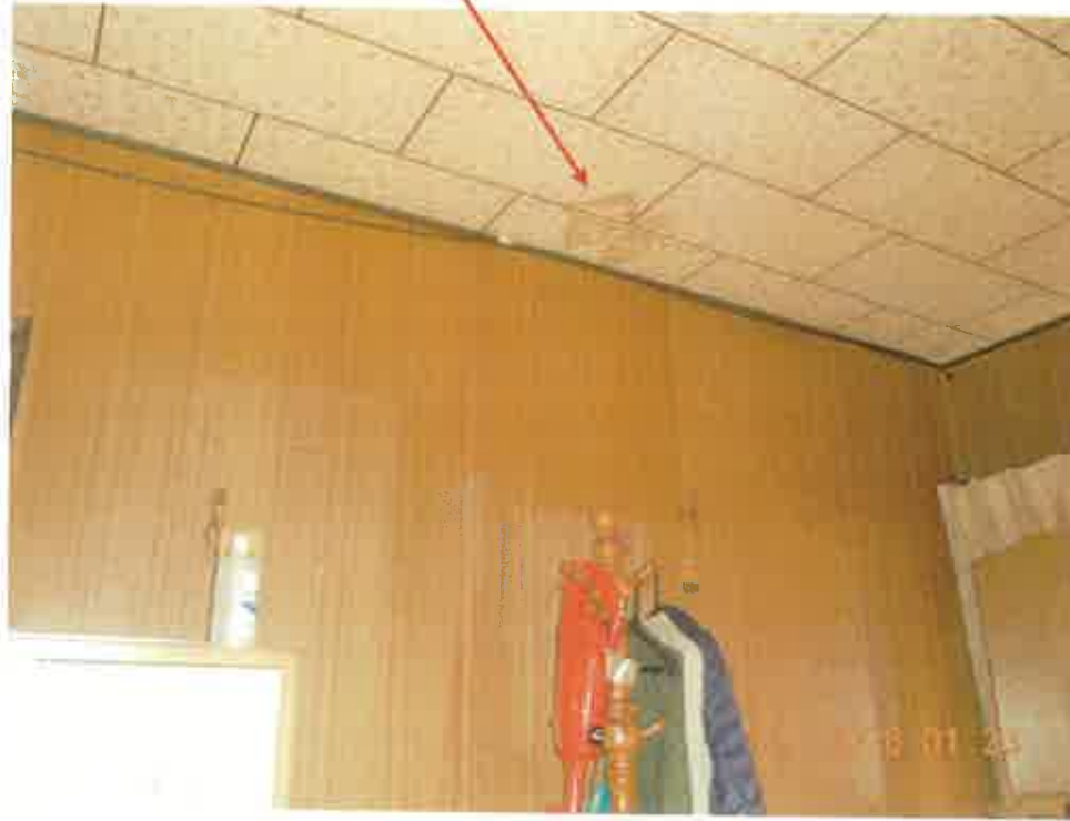
写真7 上記写真6の天井部分の雨漏り跡（撮影位置の図示は省略）
