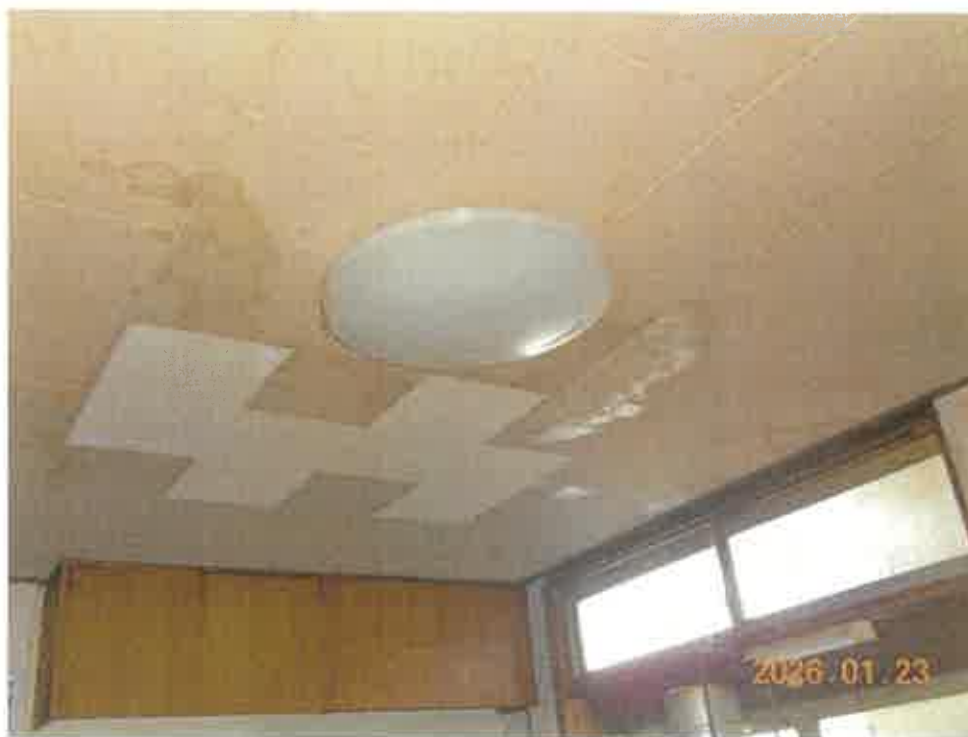
写真 1 1 上記写真 1 0 の天井部分の雨漏り跡（撮影位置の図示は省略）
