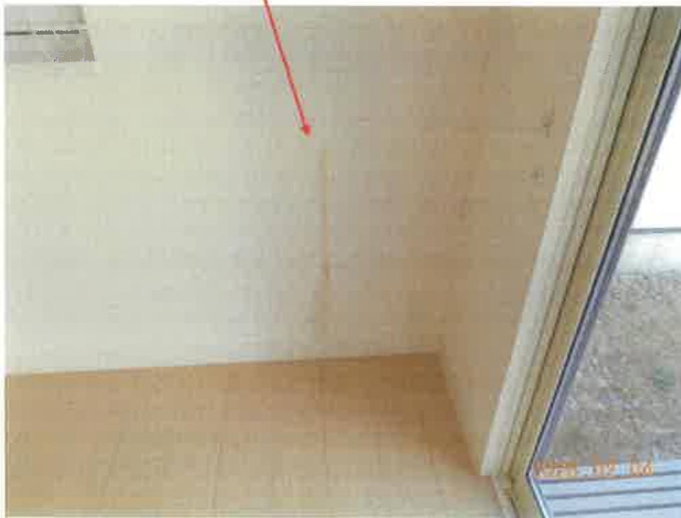
写真7 本件建物1階居間・食堂部分のクロスの剥がれ箇所（撮影位置の図示は省略）
