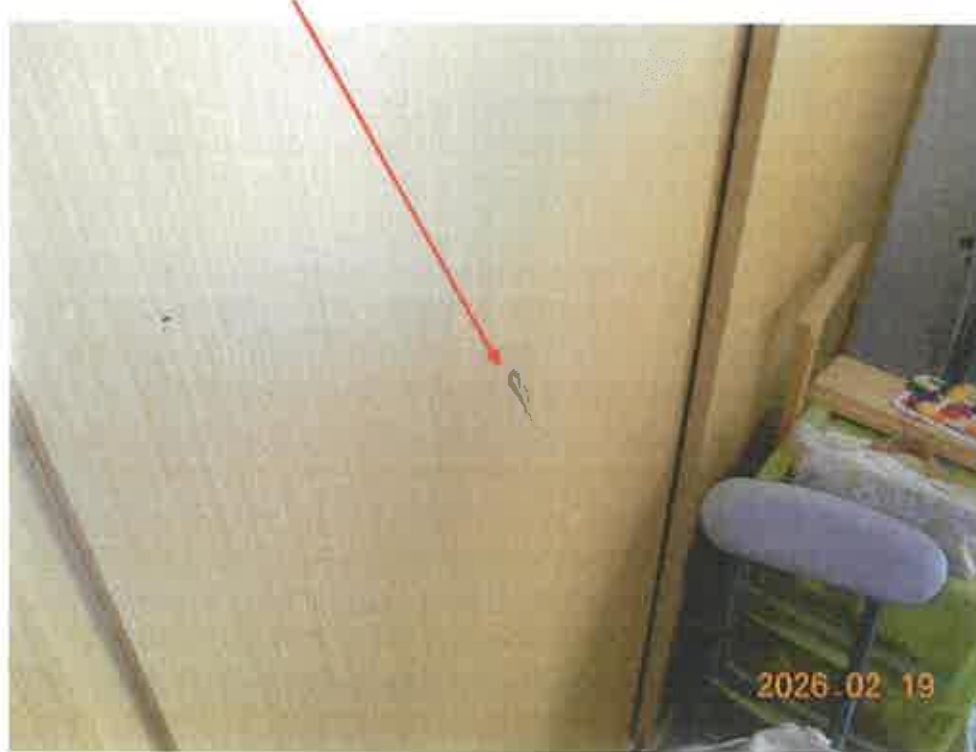
写真9 上記写真8の洋室内の引戸の損傷箇所（撮影位置の図示は省略）
