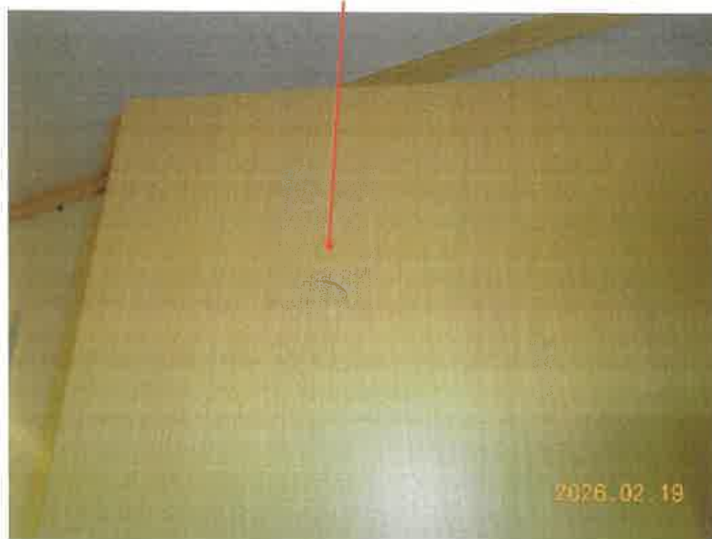
写真 1 4 上記写真 1 3 の洋室内の扉の損傷箇所（撮影位置の図示は省略）
