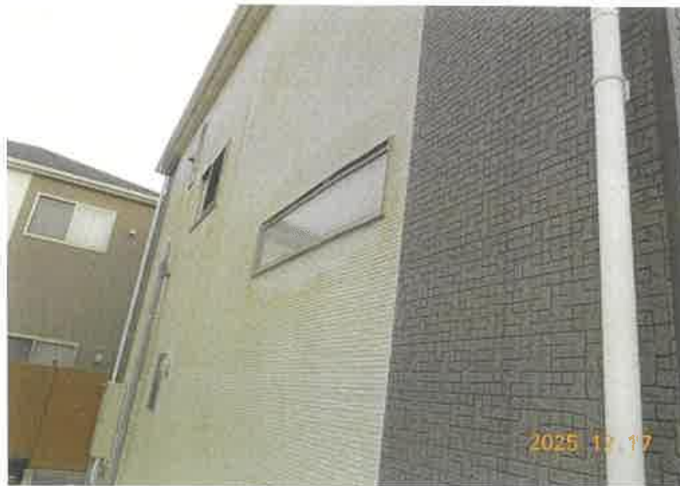
写真16 本件建物の外壁部分の汚れ箇所（撮影位置の図示は省略）
