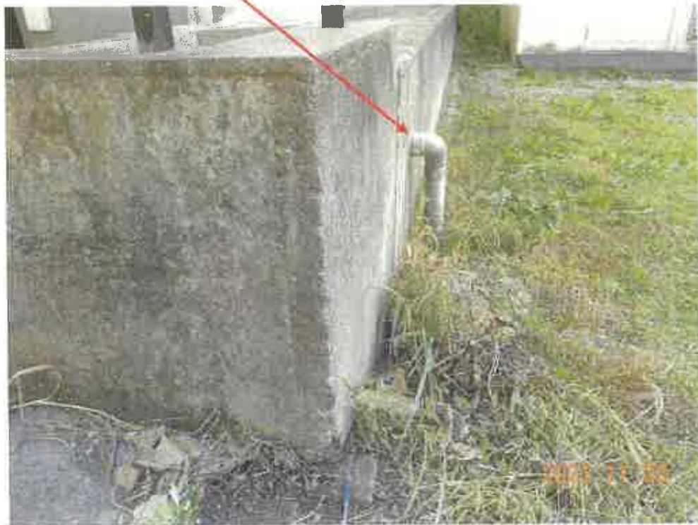
写真 2 1 物件 1 の土地西側部分の下水配管の越境部分
