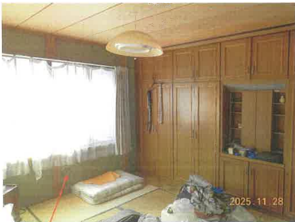
物件 2 の建物 2 階西側和室の内壁の損傷箇所
