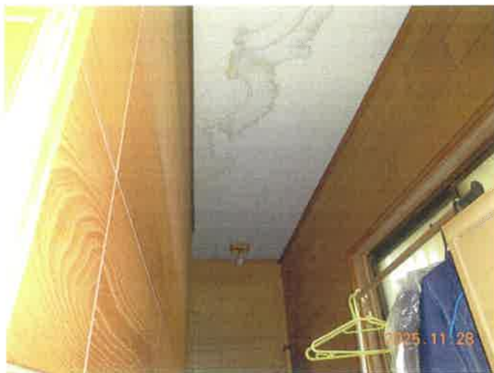
写真15 物件2の建物1階ホールの天井部分の雨漏り跡
