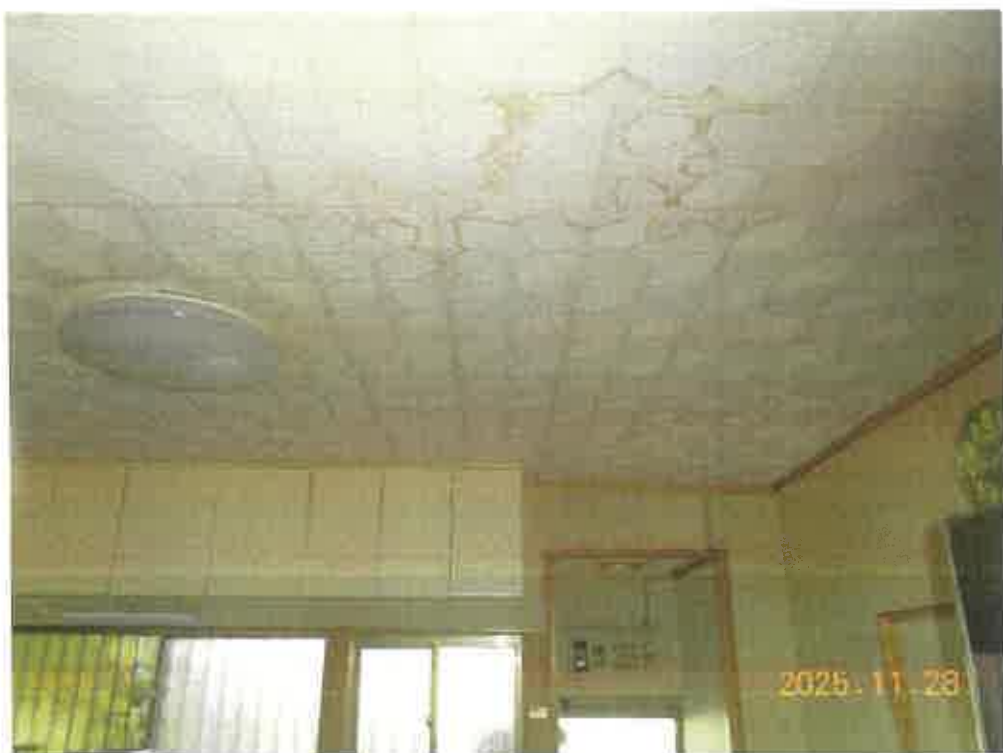
写真 1 2 物件 2 の建物 1 階東側 D K の天井部分の雨漏り跡（撮影位置の図示は省略）
