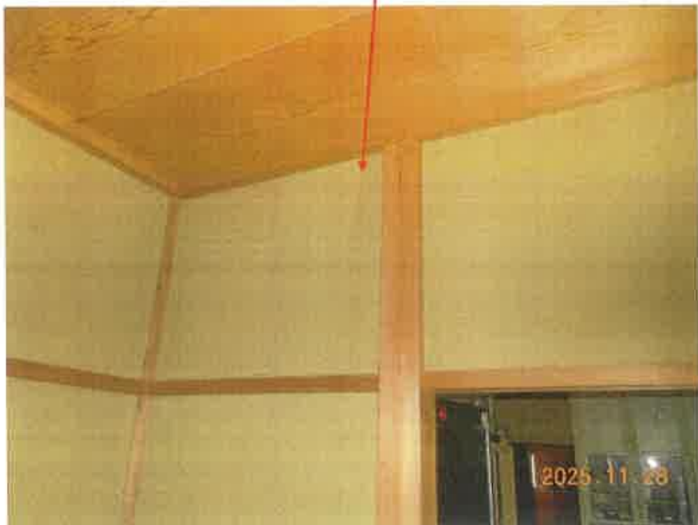
写真 1 1 物件 2 の建物 1 階南東側和室の内壁の雨漏り跡（撮影位置の図示は省略）
