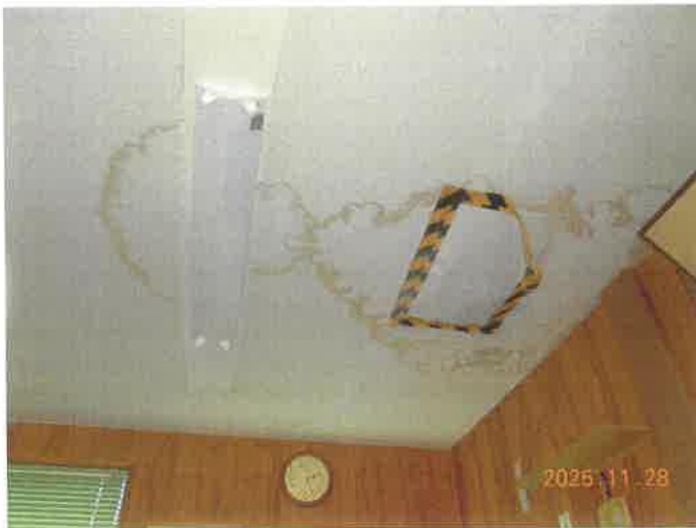
写真13 物件6の建物1階事務室の天井部分の雨漏り跡（撮影位置の図示は省略）
