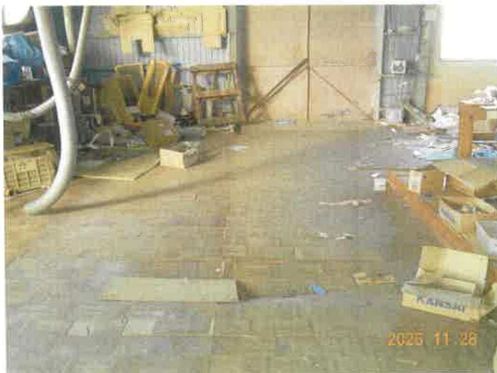
写真 2 2 物件 7 の建物の床部分の損傷箇所（撮影位置の図示は省略）
