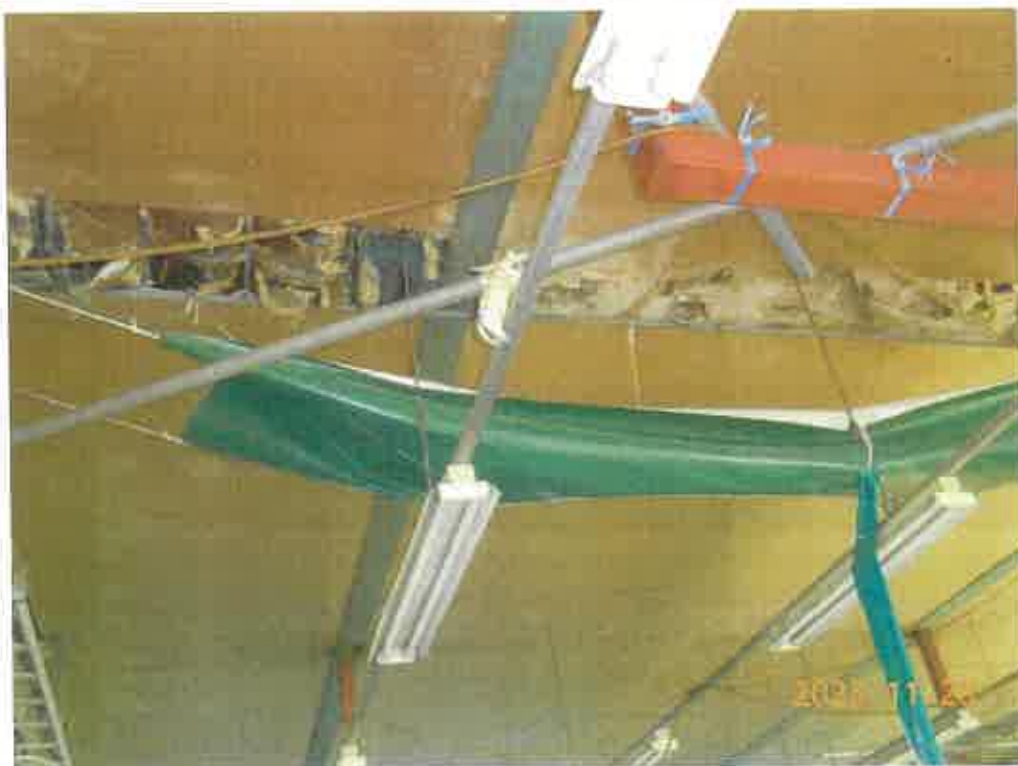
写真 2 4 物件 7 の建物の天井部分の損傷部分（撮影位置の図示は省略）
