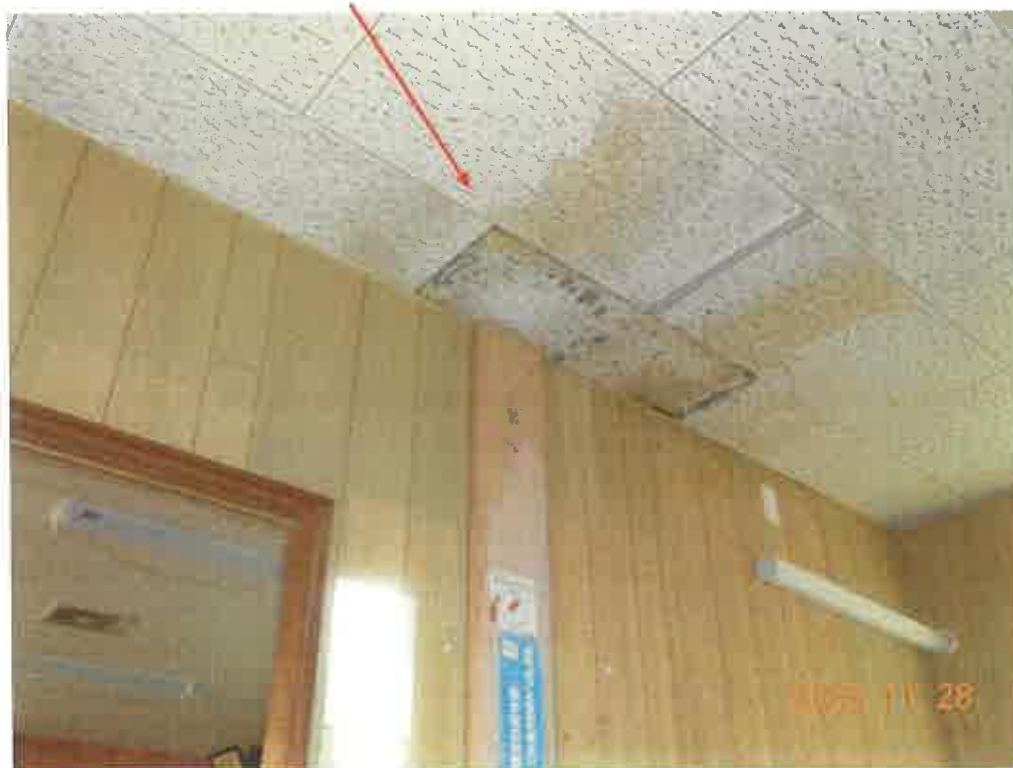
写真15 物件6の建物1階事務室の天井部分の雨漏り跡（撮影位置の図示は省略）
