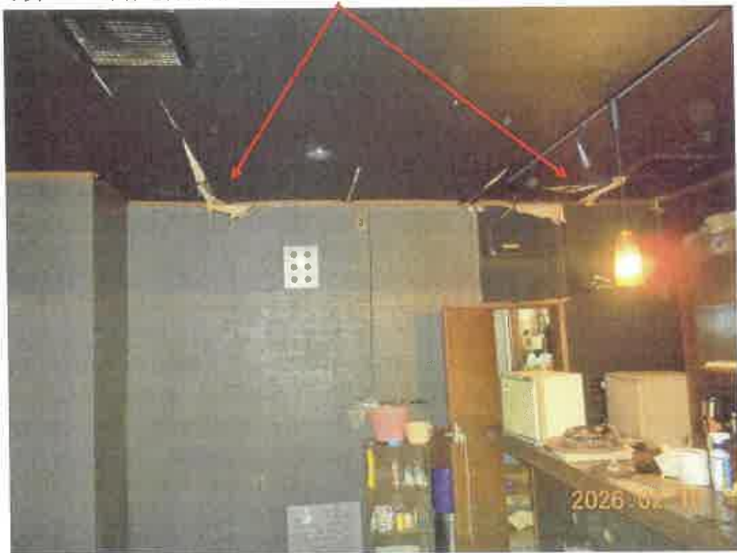
写真 3 0 本件建物店舗内の天井部分の損傷（雨漏り等）箇所（撮影位置の図示は省略）
