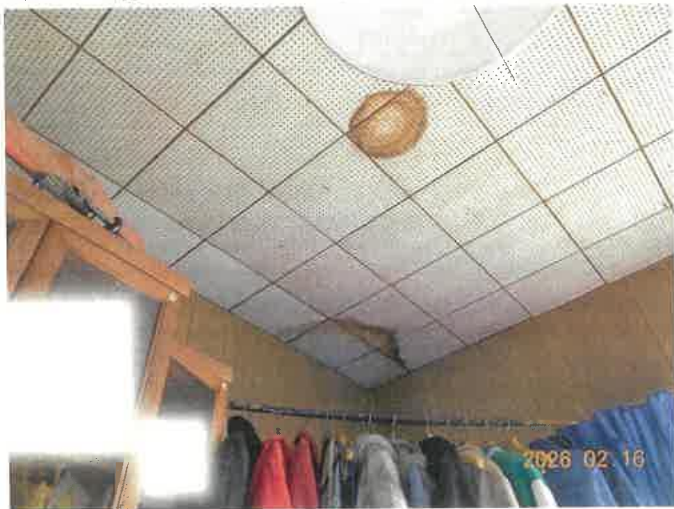
写真 1 5 前記写真 1 4 の洋室の天井部分の雨漏り跡（撮影位置の図示は省略）
