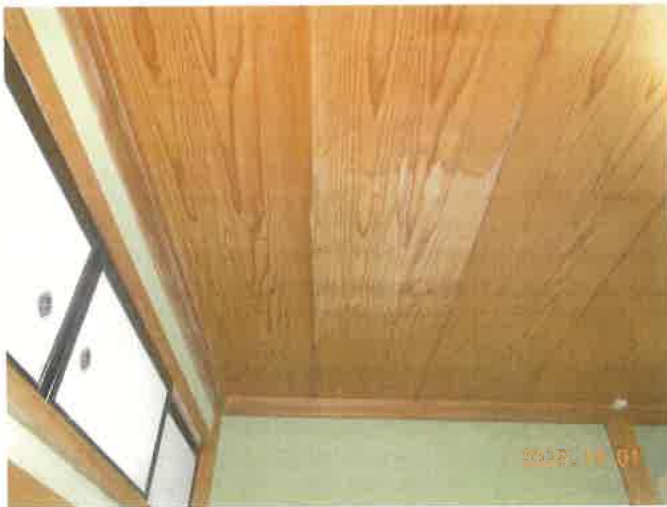
写真 1 5 物件 3 の建物南東側和室の天井部分の雨漏り跡（撮影位置の図示は省略）
