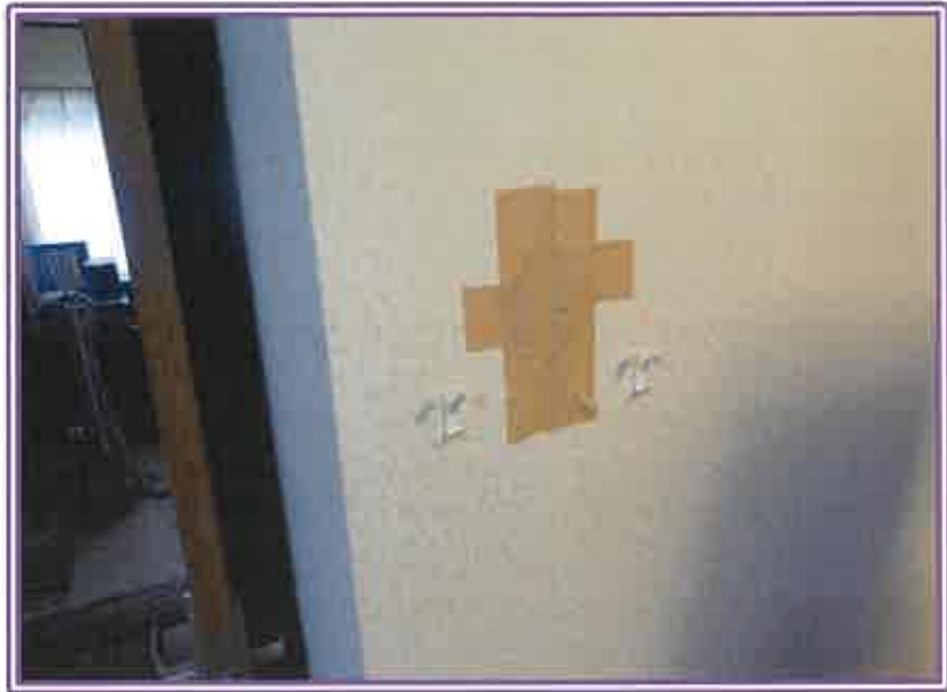
壁の陥没箇所
