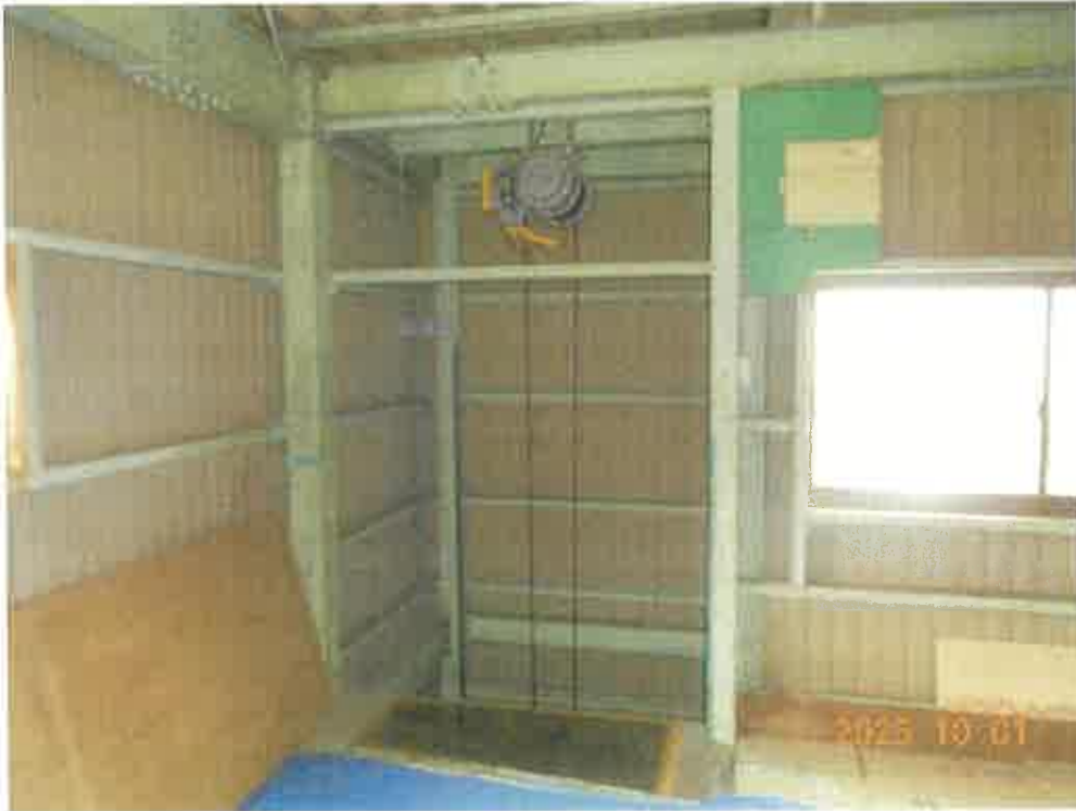
写真 2 1 2階倉庫部分の荷物用エレベーター
