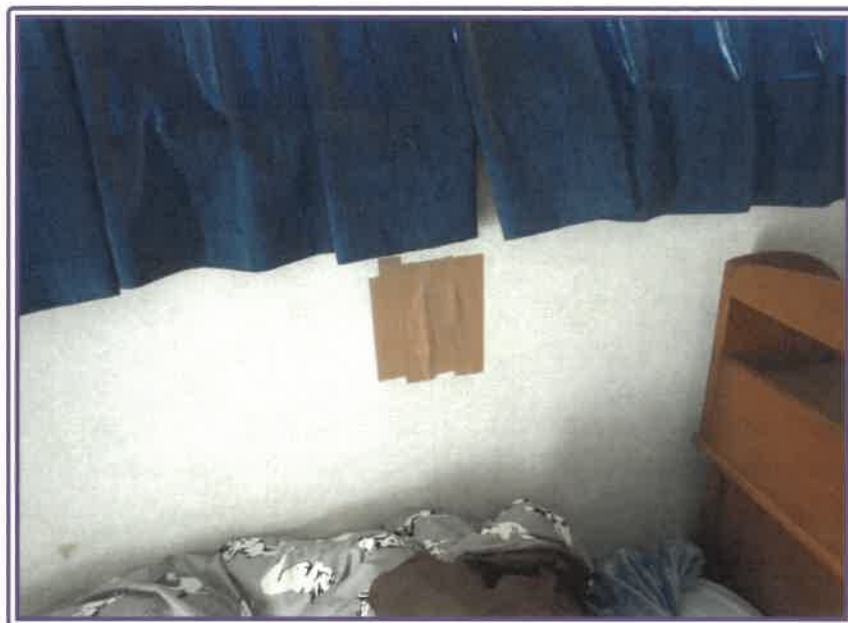
壁の陥没箇所
