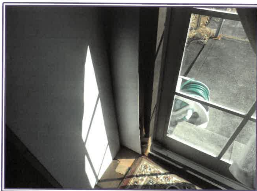
漏水による損傷箇所
