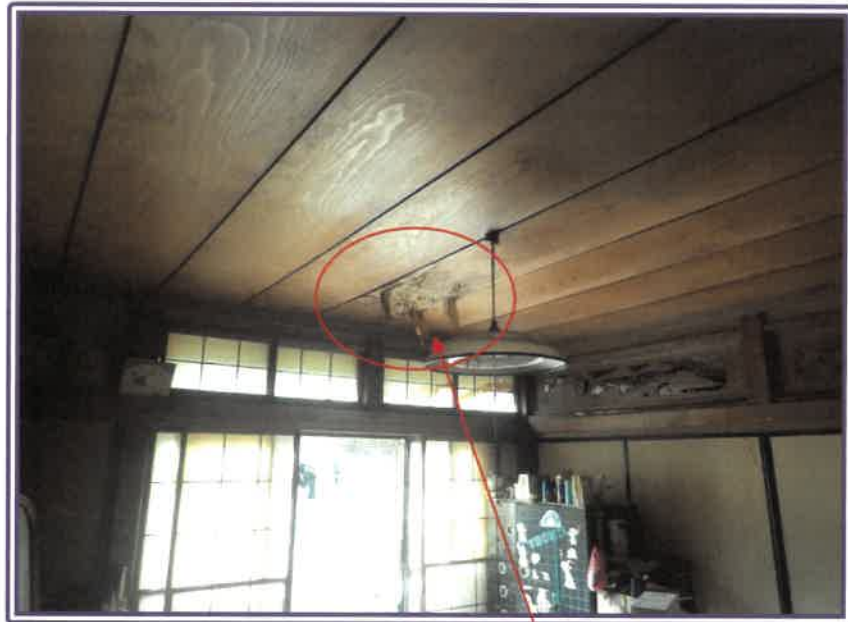
雨漏りによる損傷箇所
