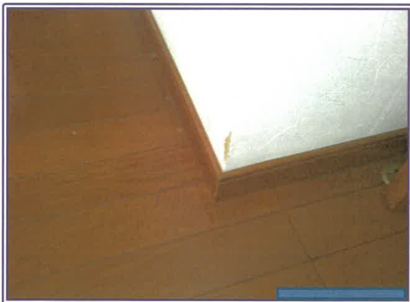
クロスの損傷箇所
