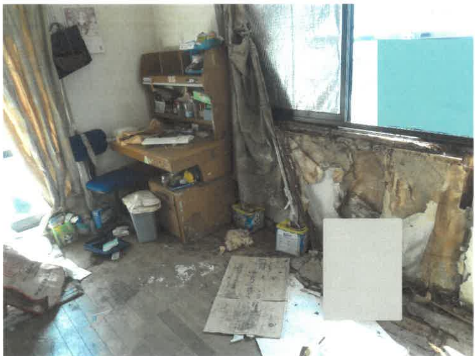
写真8 (物件2主である建物西側の損傷状態)
