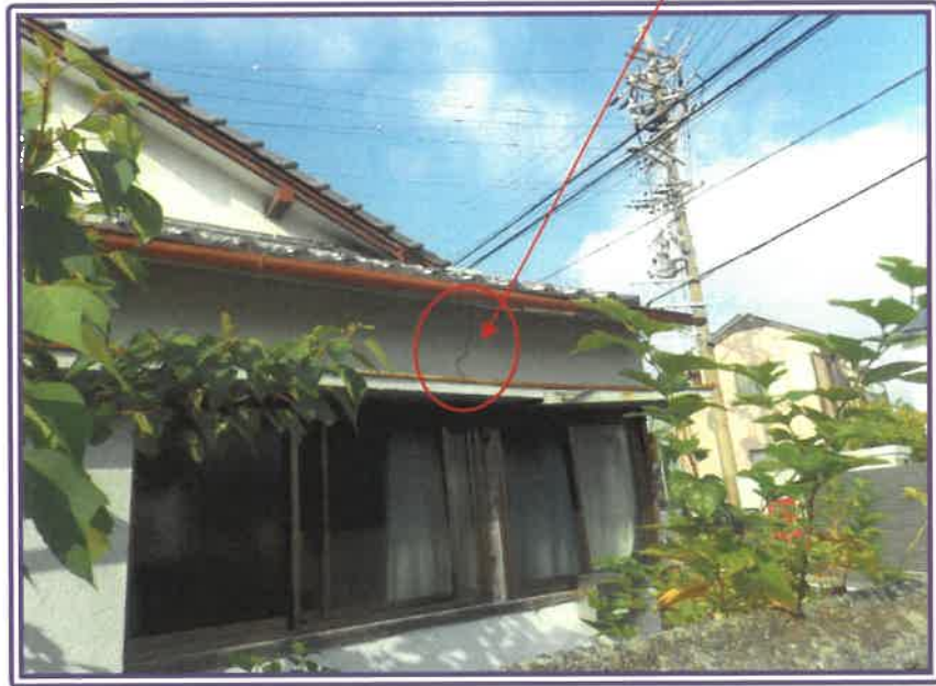
外壁に生じた亀裂
