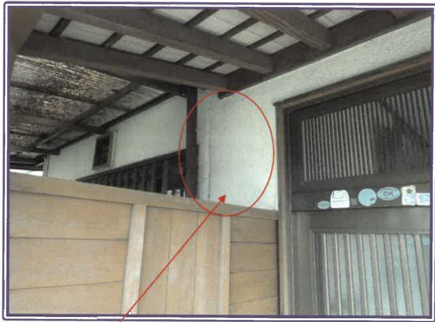
外壁に認められるクラック
