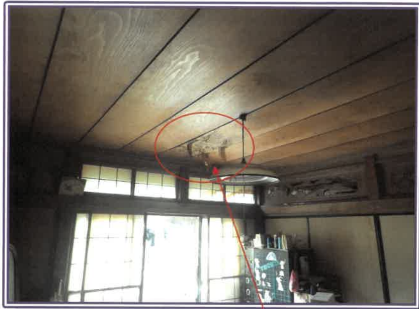
雨漏りによる損傷箇所
