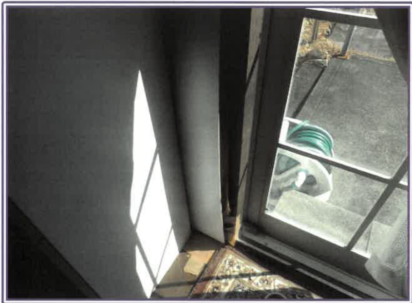
漏水による損傷箇所
