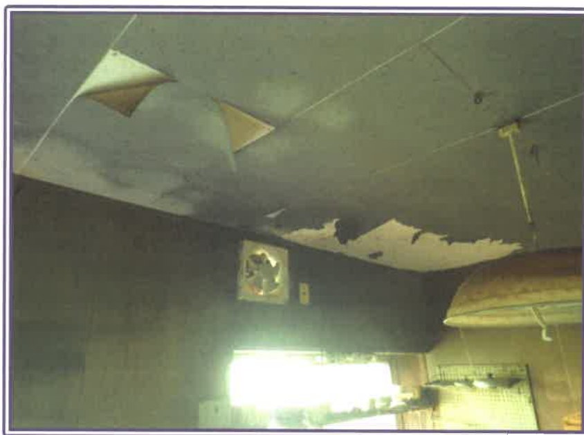
台所天井の損傷状況
