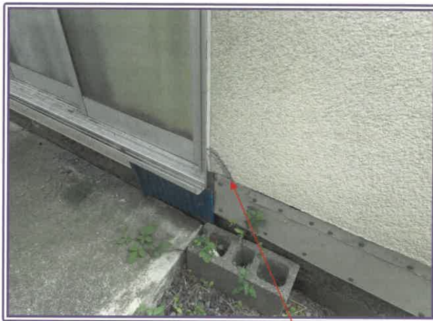
外壁に認められる亀裂
