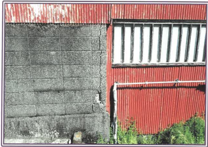
外壁に生じた亀裂
