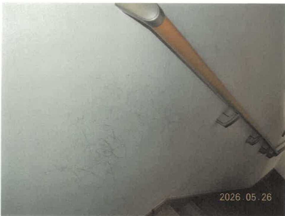
写真 1 6 本件建物 2 階階段部分の壁クロスの落書き、汚れ部分（撮影位置の図示は省略）
