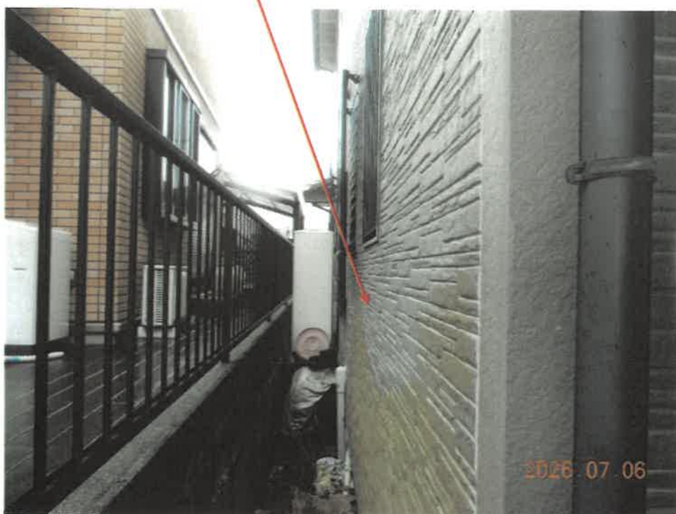
写真 1 6 本件建物外壁の汚れ（コケ）箇所（撮影位置の図示は省略）
