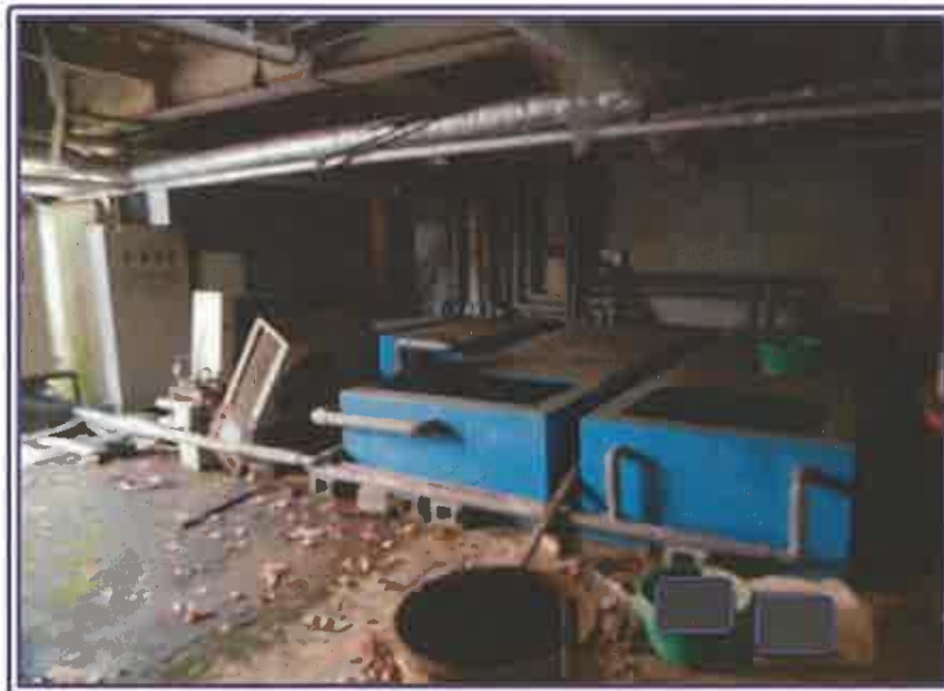
いけす置場（北棟・地下1階）
