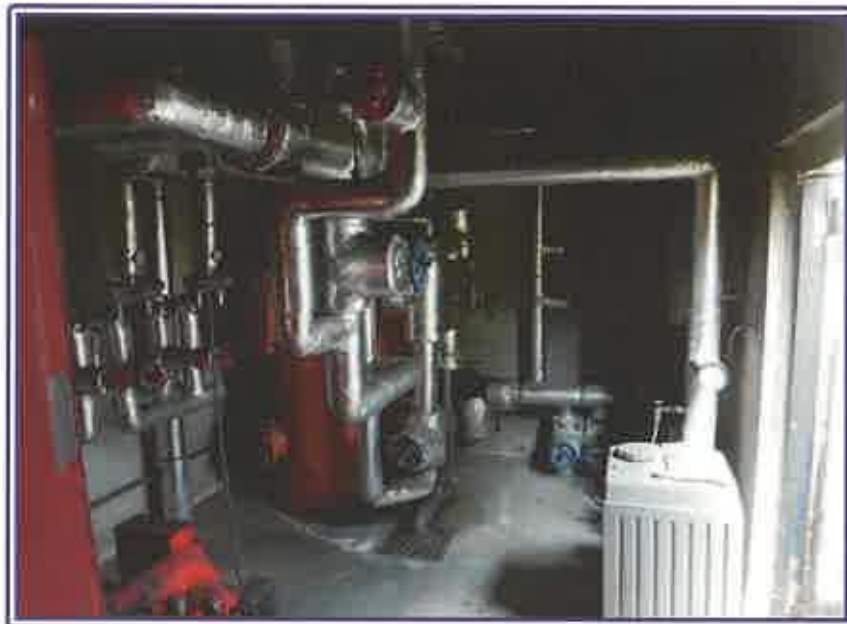
ボイラー室（南棟）
