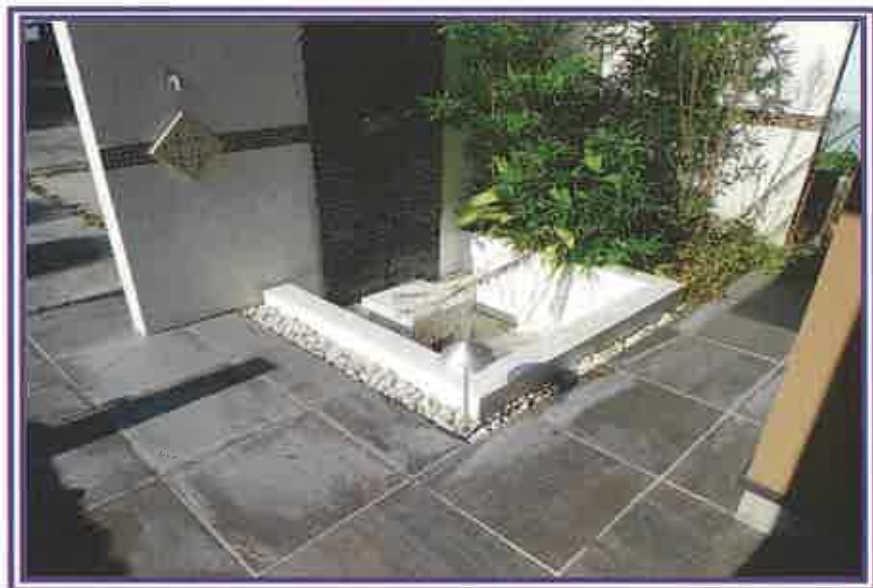
エントランス付近に設置されている水槽様の構造物及びその周辺を撮影したもの
