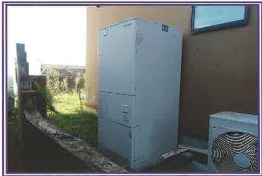
ヒートポンプ給湯設備及びその周辺を撮影したもの
