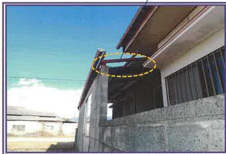
下屋の損傷箇所を撮影したもの
