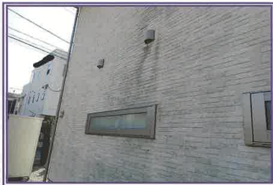
本件建物の北側外壁に汚れが認められる状況を撮影したもの
