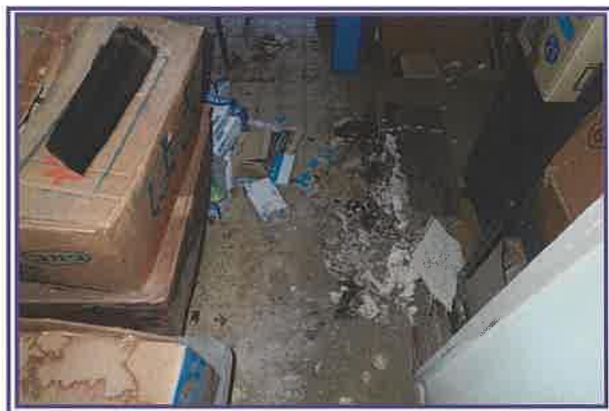
床の損傷箇所を撮影したもの(台所)
