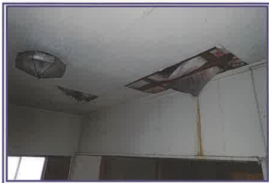
天井の損傷箇所を撮影したもの(台所)
