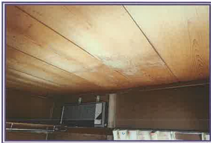
雨漏り跡を撮影したもの(和室4)
