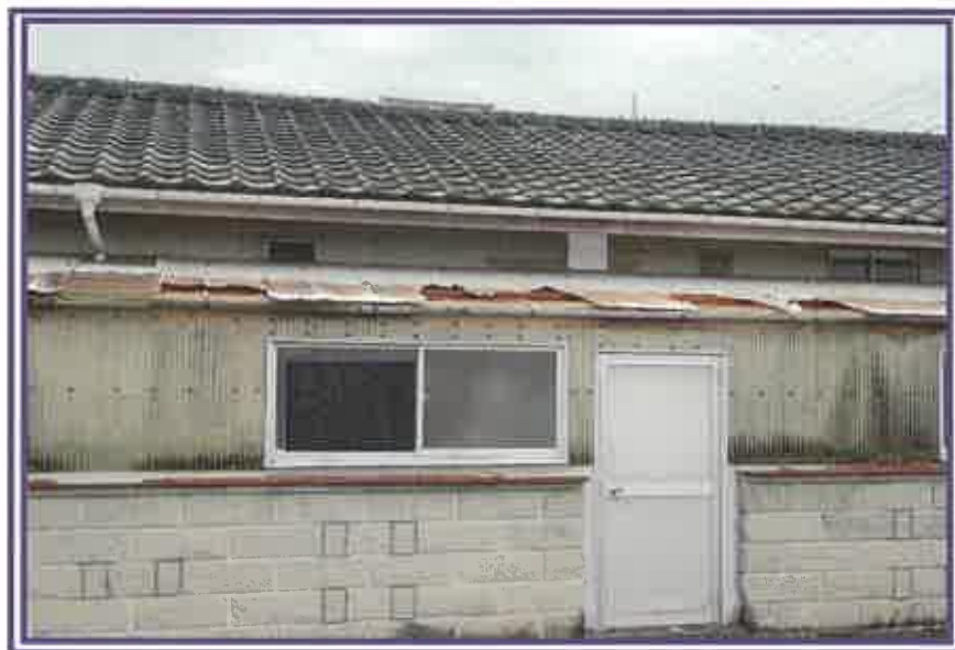
下屋の屋根に損傷が認められる状況を撮影したもの
