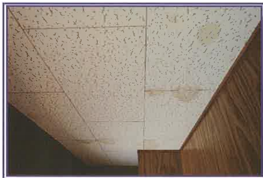
雨染み箇所を撮影したもの(東側廊下)
