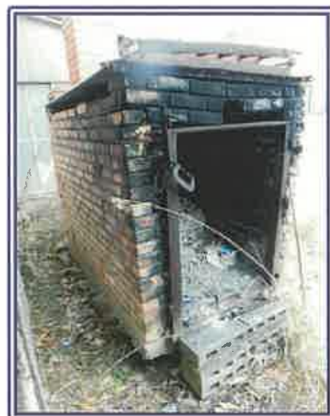
物件3・主たる建物（居宅）脇の 焼却炉
