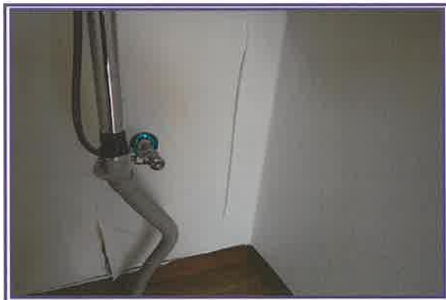
壁のクロスに、損傷が認められる状況を撮影したもの(2階洗面台付近)
