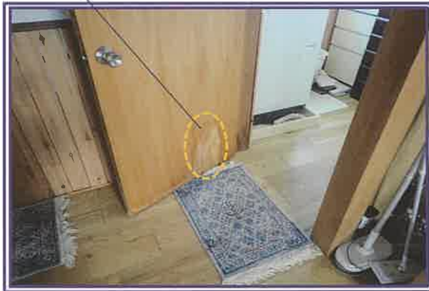
ドアの下部に、汚れが認められる状況を撮影したもの(脱衣室入口ドア)
