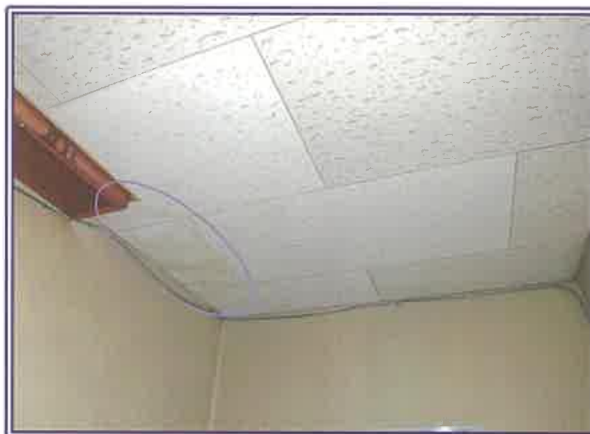
天井のシミ（天井板の貼り替えがされている）
