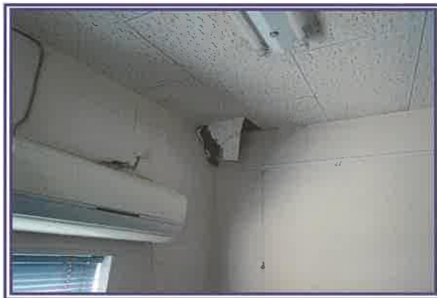
店舗2内の、天井の損傷箇所を撮影したもの(物件6(店舗))
