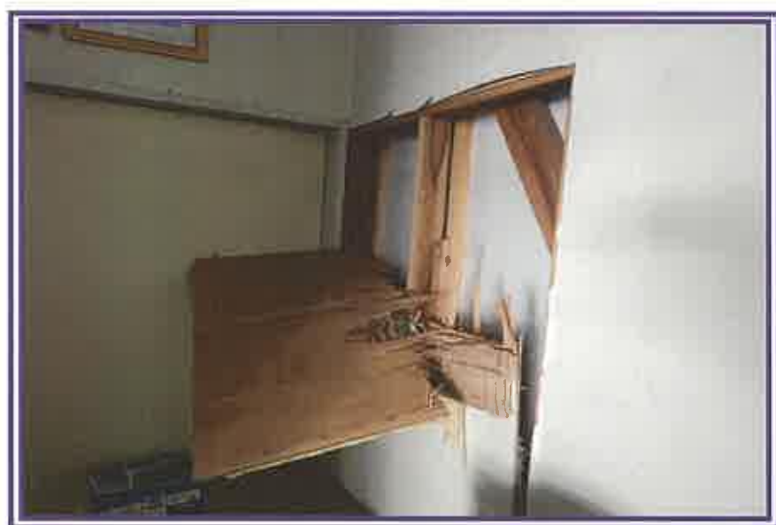
店舗1内の、壁の損傷箇所を撮影したもの(物件6(店舗))
