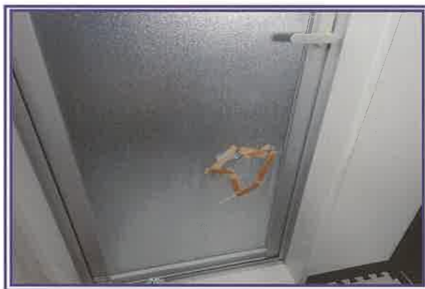
浴室入口ドアの損傷箇所を撮影したもの(物件5(居宅))
