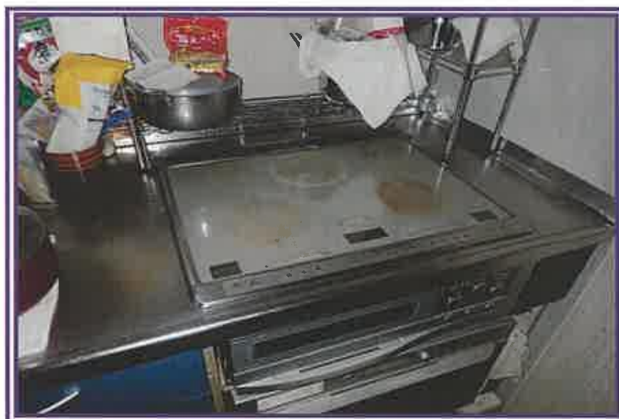
IHクッキングヒーターを撮影したもの
