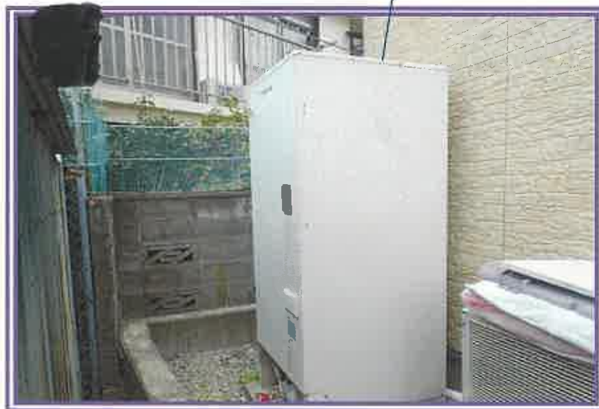
ヒートポンプ給湯設備
