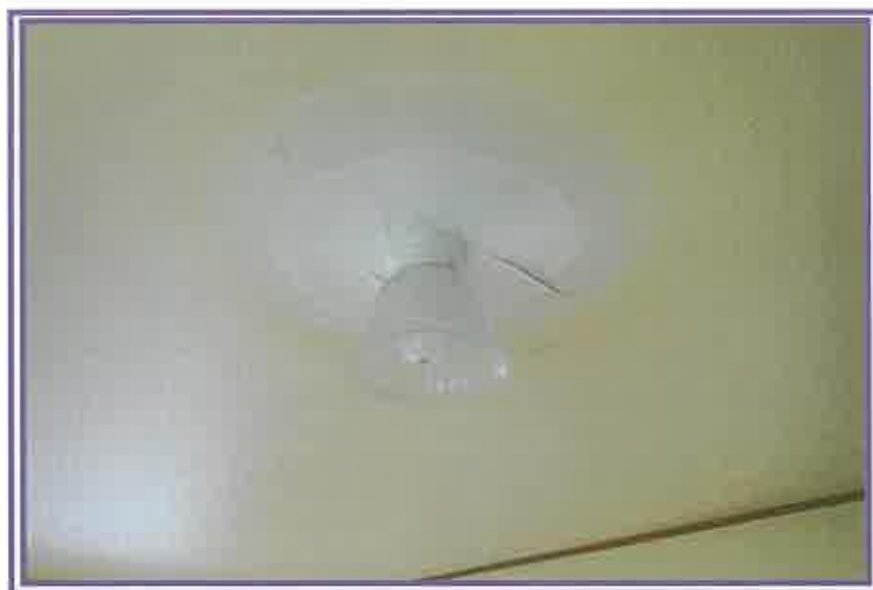
洋室3の天井クロスに、損傷が認められる状況を撮影したもの
