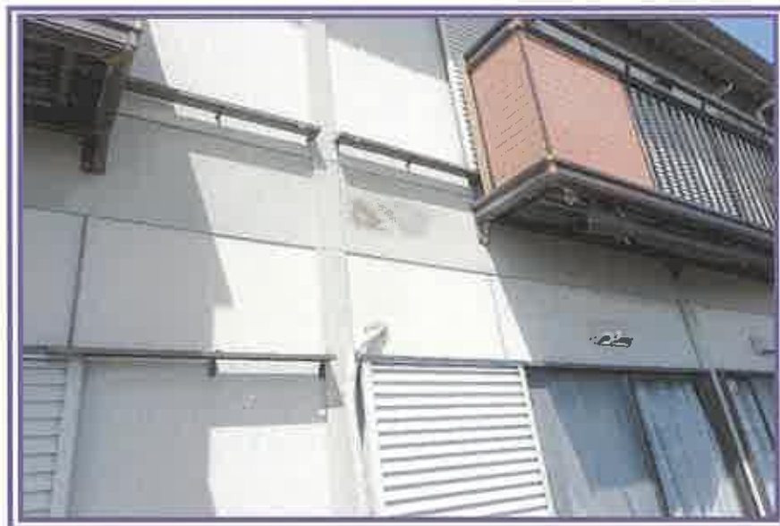
物件2(共同住宅)の外壁(表面)に損傷が認められる状況を撮影したもの
