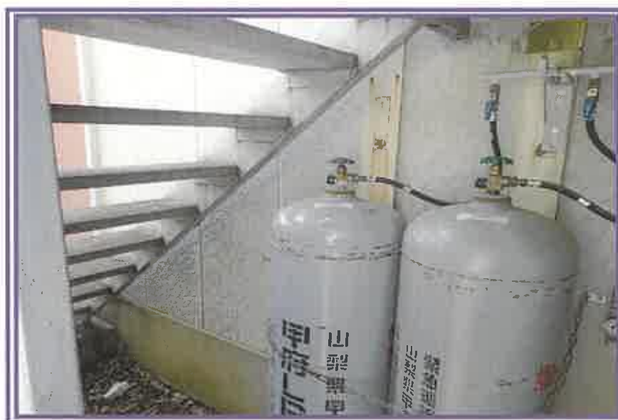
LPガス貯蔵設備の内部を撮影したもの
