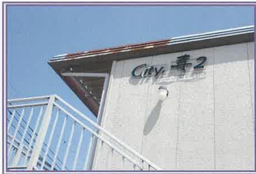
物件2(共同住宅)の屋根(一部)が錆びている状況を撮影したもの
