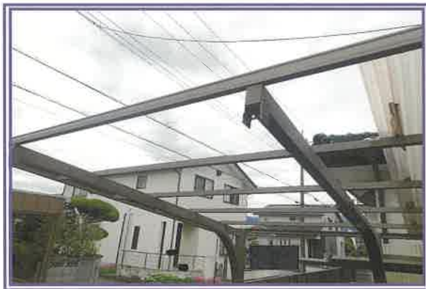
カーポートの屋根(一部)が、取り外されている状況を撮影したもの
