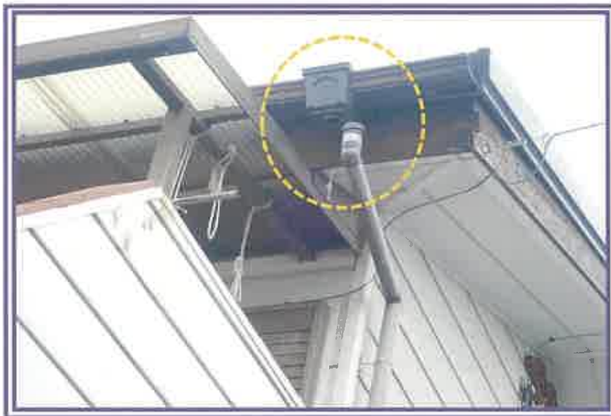
雨樋の集水器から、パイプ(エルボ)が外れている状況を撮影したもの(拡大撮影)
