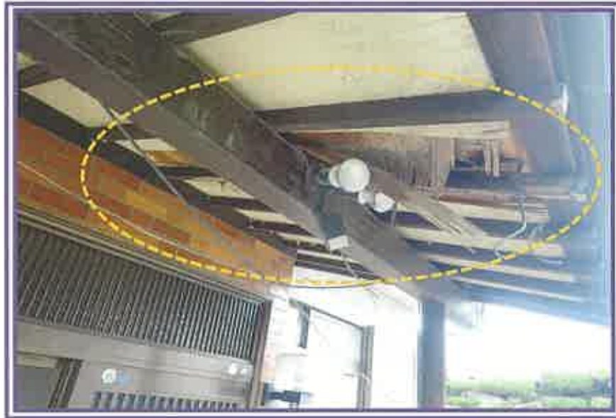
軒天に損傷が認められる状況を撮影したもの
