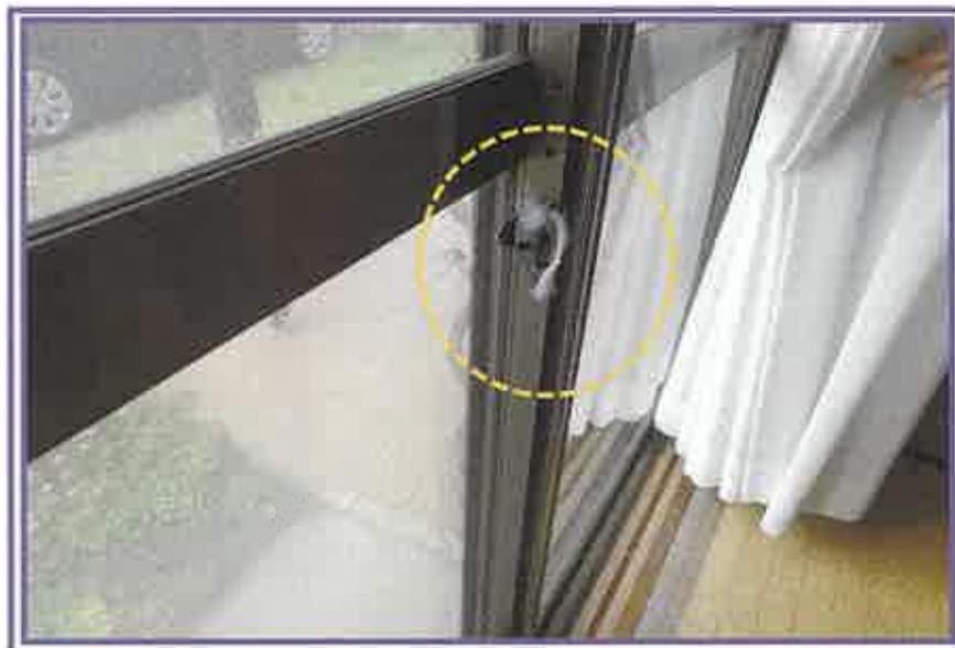
掃き出し窓の鍵が破損している状況を撮影したもの (ただし、施錠したまま固定されている状態。洋室2)
