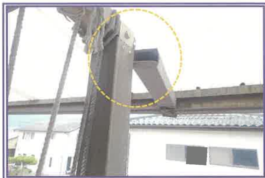
ベランダの屋根の支柱に、損傷が認められる状況を撮影したもの
