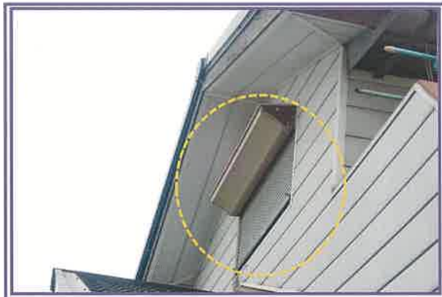
2階居室(間取図中の「洋室3」)の窓に設置されているシャッター及びその周辺を撮影したもの(関係人の陳述によると、故障により、当該シャッターは開けることができないとのことである。拡大撮影)
