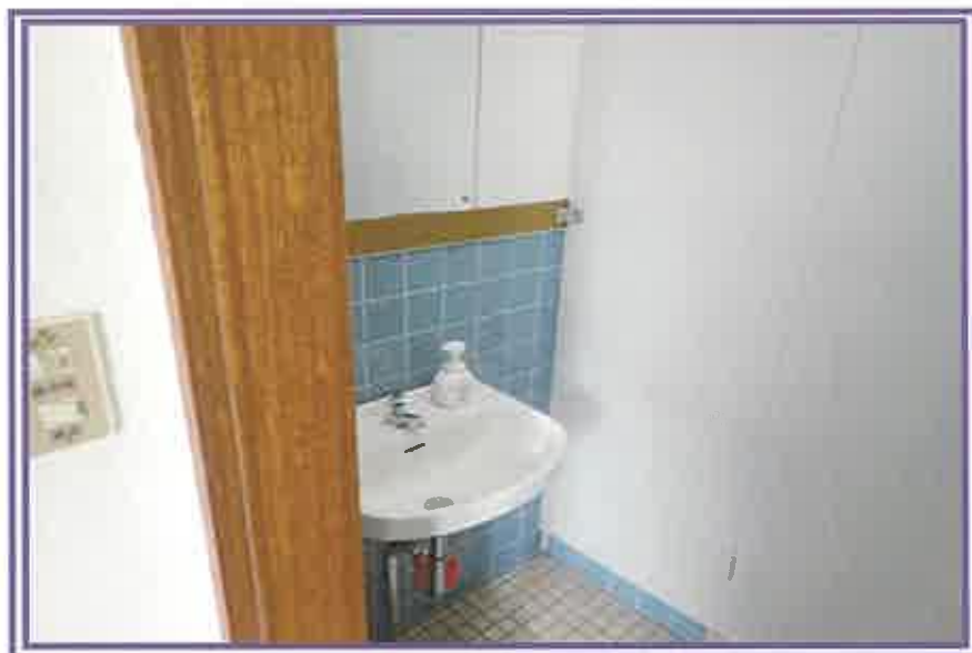
手洗器 (1階トイレ内)
