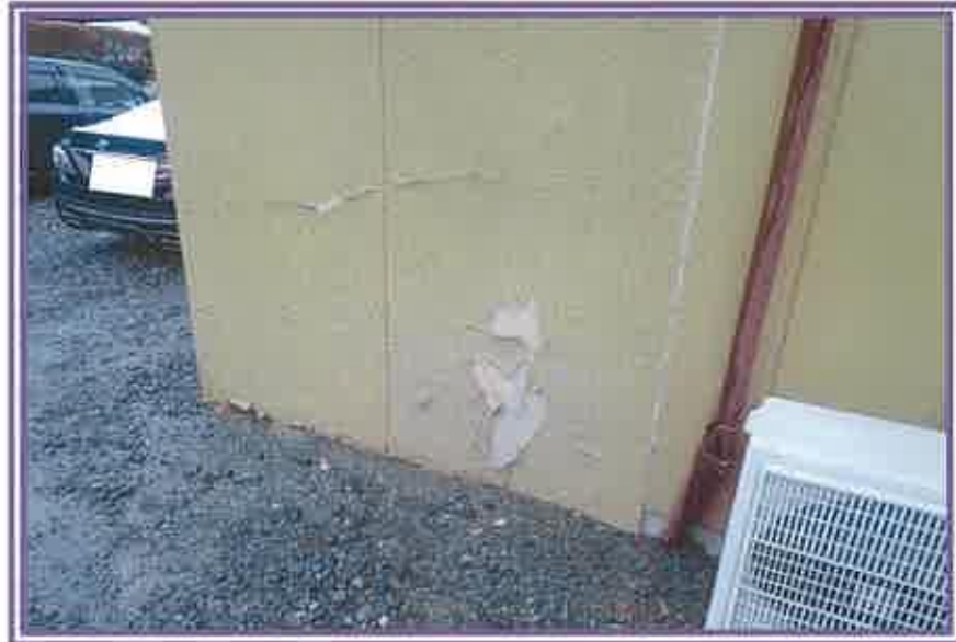
本件建物の外壁(表面)に損傷が認められる状況を撮影したもの
