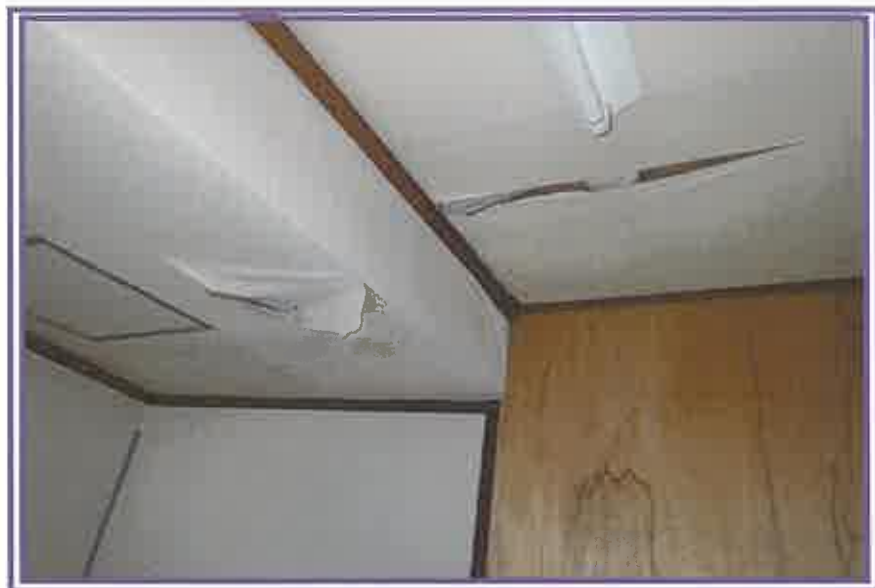
物置(事務室3内)天井のクロスに、損傷が認められる状況を撮影したもの
