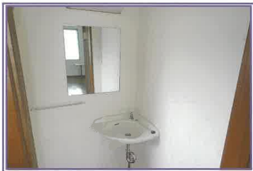
手洗器 (事務室4のトイレ内)
