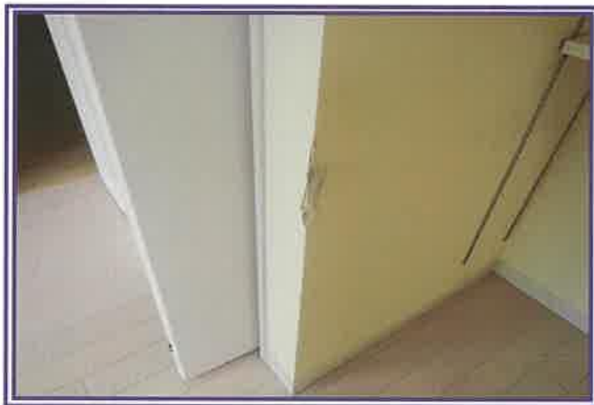
クロスの損傷が認められる状況を撮影したもの(洋室4)
