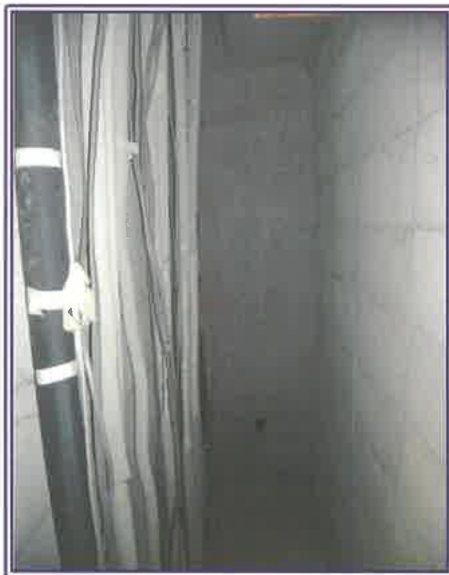
パイプスペース
