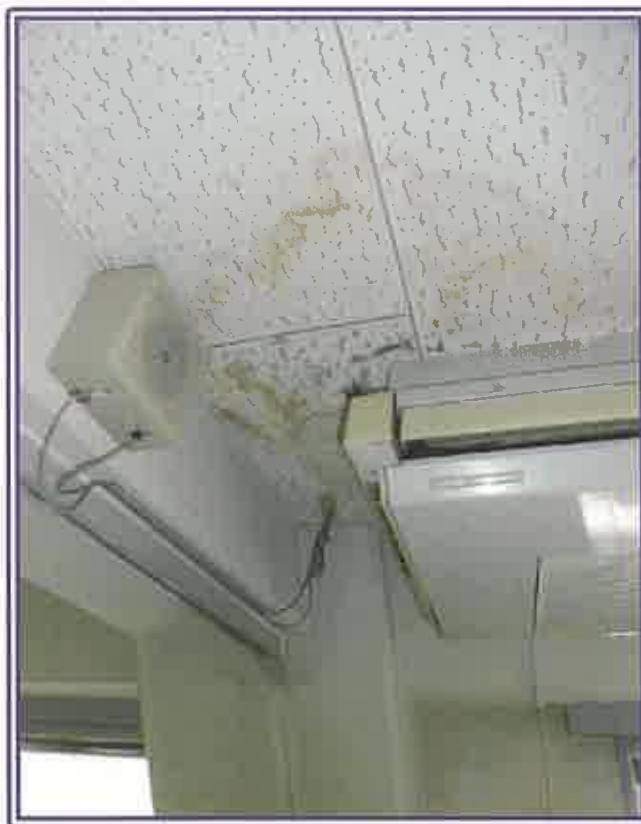
雨漏り跡（シミ）
