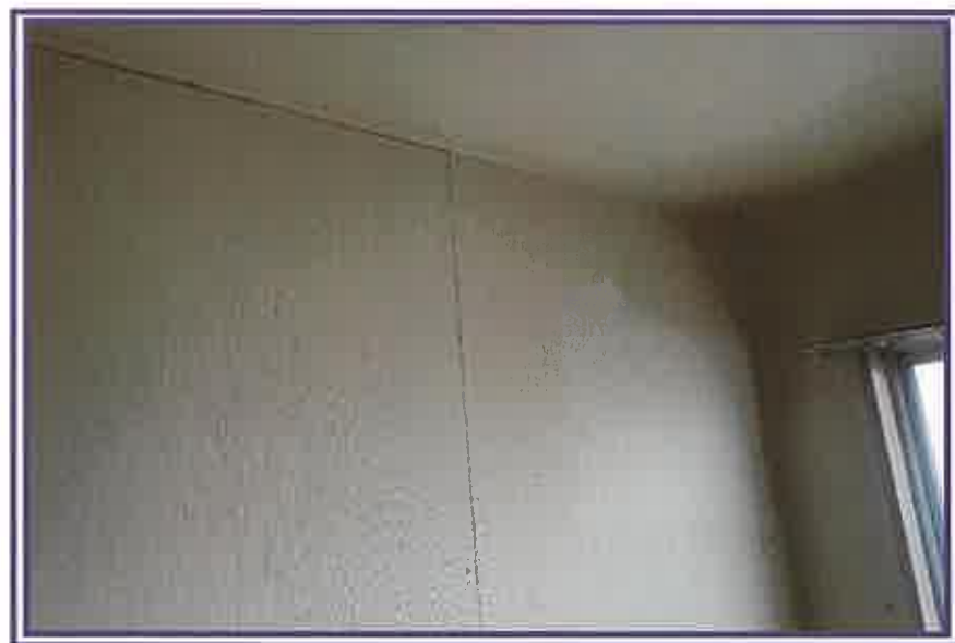
クロスの損傷箇所を撮影したもの(洋室。101号室)
