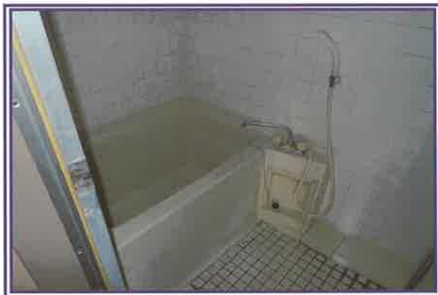
ユニットバス(205号室)
