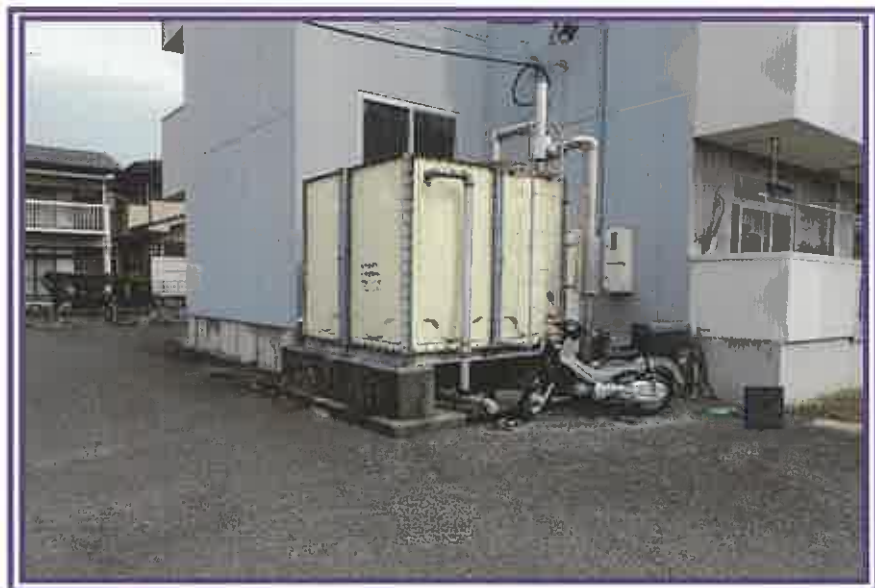
受水槽及びその周辺を撮影したもの
