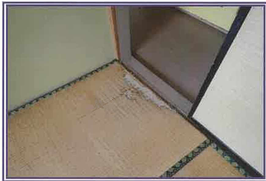
畳の損傷箇所を撮影したもの(和室2。101号室)
