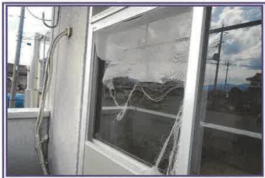
網戸の損傷箇所を撮影したもの(和室1。101号室)
