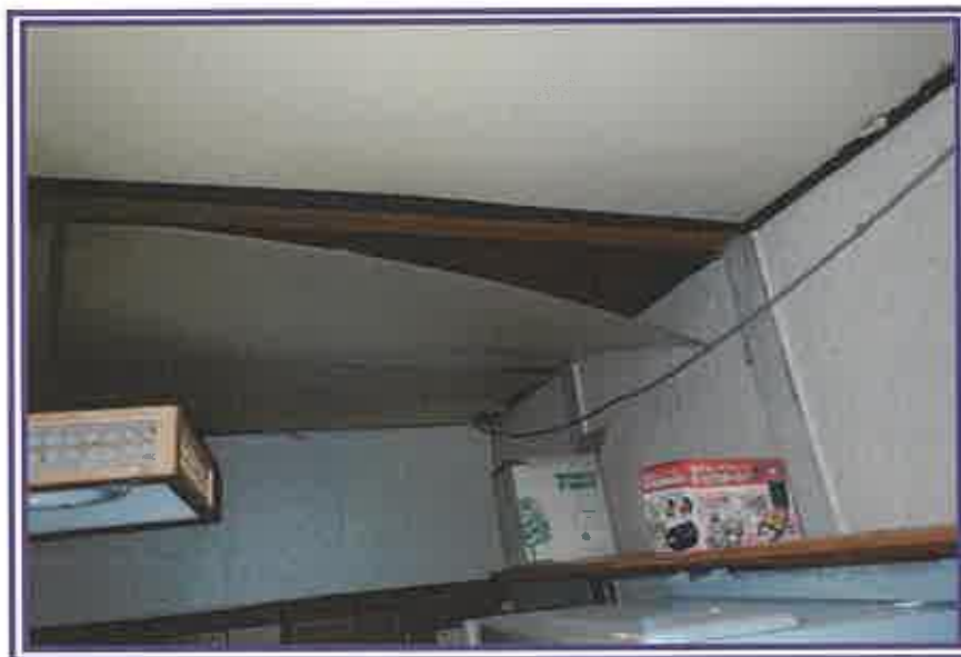
家事室の天井の板が剥がれている状況を撮影したもの
