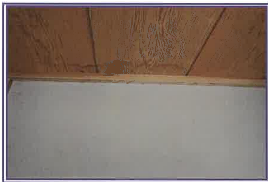
天井付近の雨漏り跡を撮影したもの(和室1)
