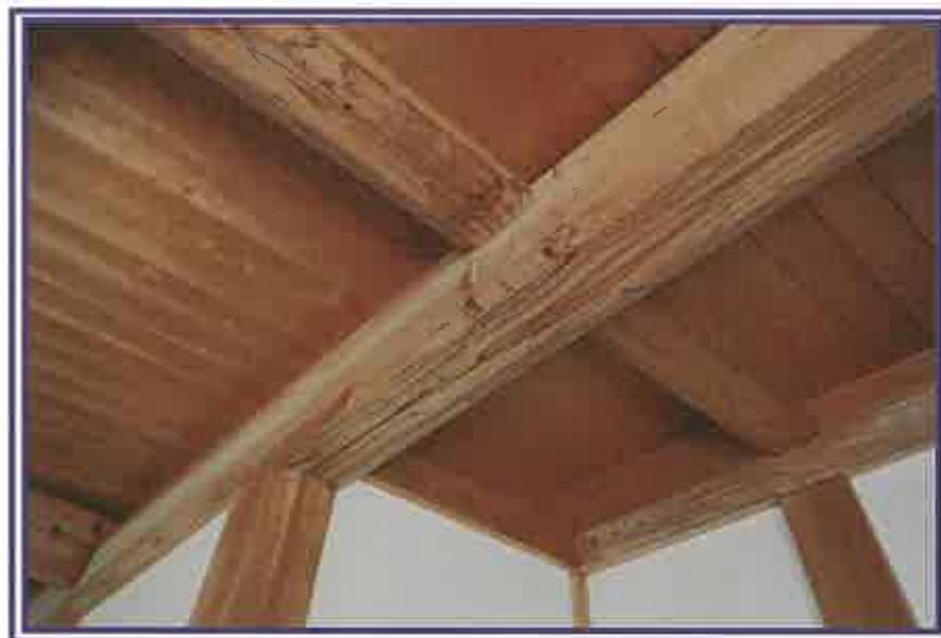
天井付近の雨漏り跡を撮影したもの(洋室1)
