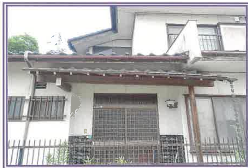
本件建物の玄関の庇が傾いている状況を撮影したもの
