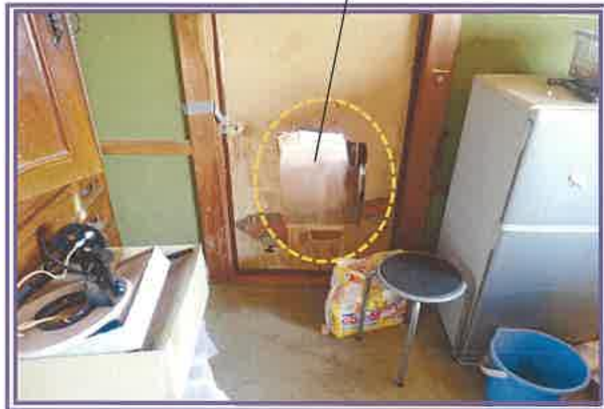
和室1のドア(下部)に、穴が開いている状況を撮影したもの
