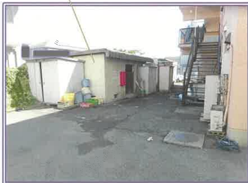
敷地裏の供給設備の状況
