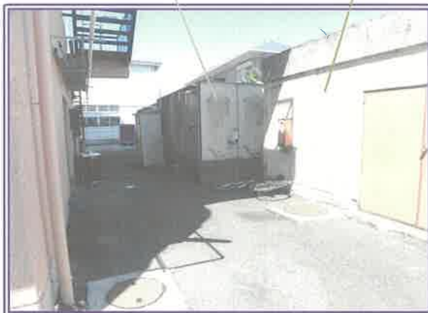
敷地裏の供給設備の状況
